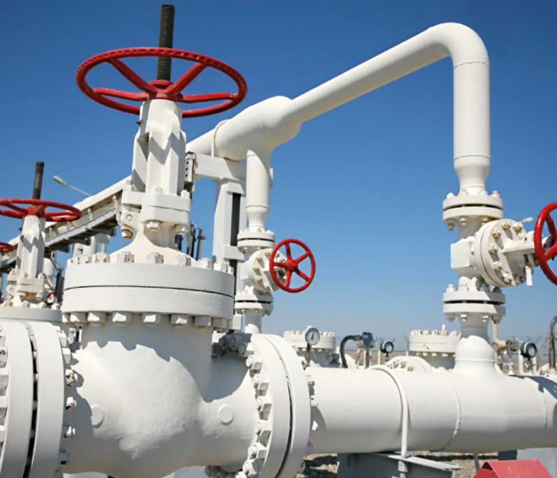
▲ Cañerías de gas natural.
